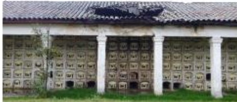
Estado actual de la cubierta. Una amenaza para la obra "Auras Anónimas". Fuente: Visita IDPC, febrero 2020.
